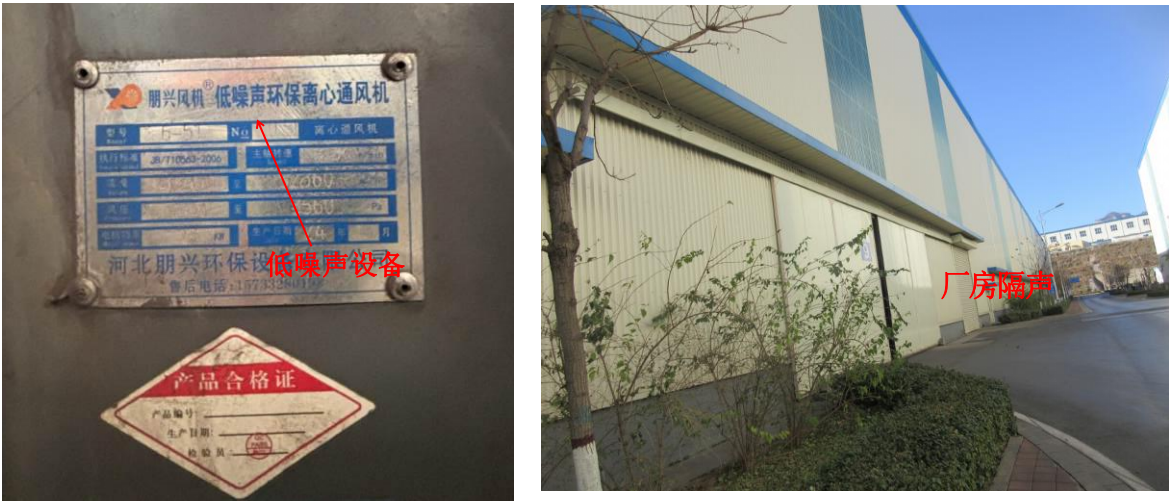
图 4-2 噪声治理设施落实情况
